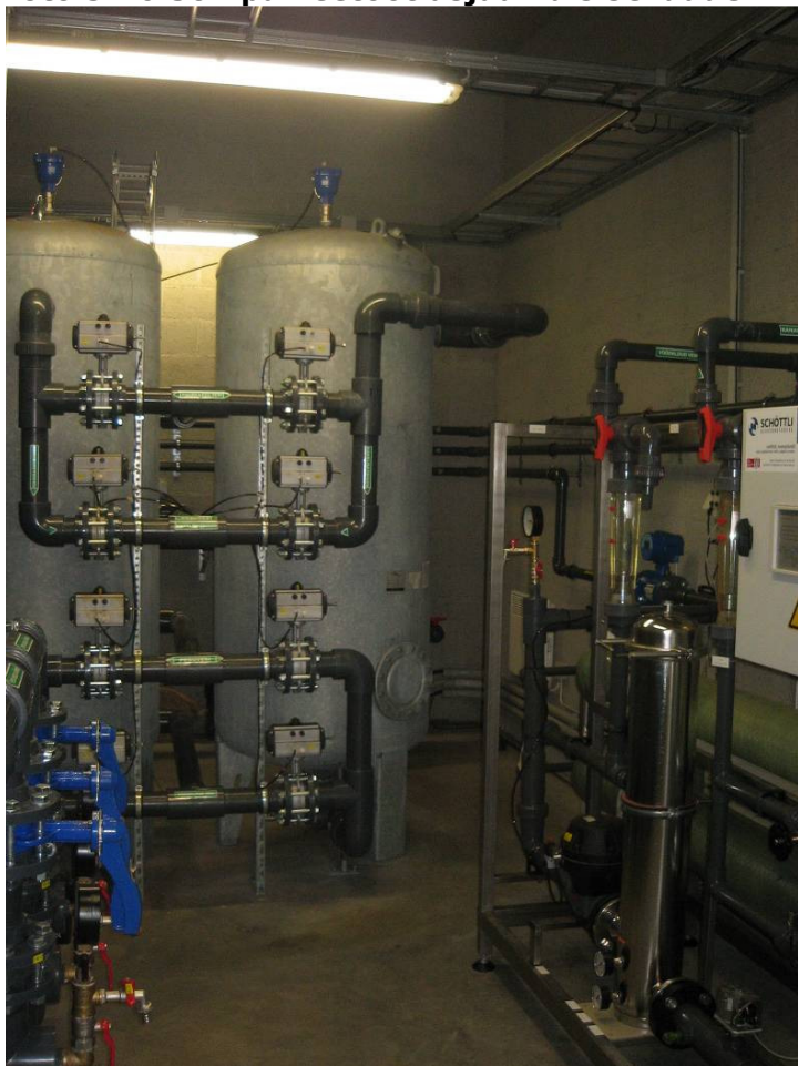
Foto 5.16 Sompa veetöötlusjaama sisevaade
