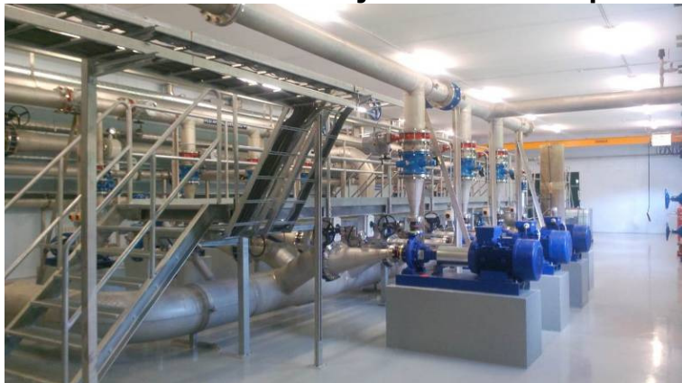
Foto 5.4 Ahtme veetöötlusjaam. Survetõstepumbad
