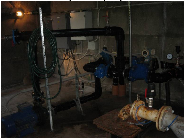
Foto 5.12 Kukruse puurkaevpumpla sisevaade
