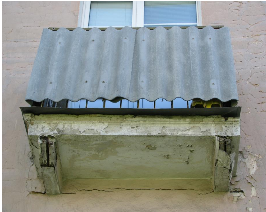
Foto 7. Piire on kaetud sobimatute eterniitplaatidega, plaadid eemaldada ja piire korrastada. Rõduplaati kandvad terastalad on kaetud puiduga, terastalad on roostetanud. Enne remonttöid kontrollida kandekonstruktsiooni ja hüdroisolatsiooni seisukorda. Terasdetailid puhastada ja katta korrosioonikaitsevahendiga.
