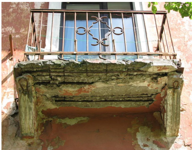
Foto 5. Rõdu kandekonstruktsioonid on oluliselt lagunenud ja deformeerunud. Seisukord on avariiline. Konstruktsioonid vajavad suures osas asendamist. Enne ehitustöid on vajalik koostada projekt.
