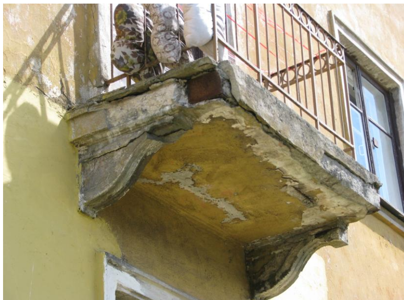
Foto 2. Rõdu kandekonstruktsioonid on oluliselt kahjustunud. Rõdu kandvad terastalad on korrodeerunud ja puudub kaitsev betoonkiht. Karniisid ja konsoolid vajavad taastamist. Lahtine betoon eemaldada, puhastada terastalad ja korrodeerunud sarrus. Hinnata terasdetailide jääkristlõiget ja vajadusel konstruktsioone tugevdada. Puhastada rõdu pealmine pind, eemaldada varasemad pealiskihid ja paigaldada hüdroisolatsioon koos ülespöörete ja servaplekiga.
