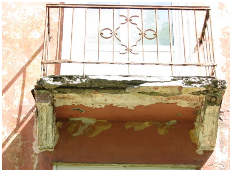
Foto 4. Puuduva servapleki ja ebapiisava hüdroisolatsiooni tõttu on rõduplaadi äär oluliselt lagunenu. Värvkate ja lahtine betoon eemaldada. Sarrusvardad puhastada, vajadusel lisada täiendav terasarmatuur. Võib osutada vajalikuks rõduplaadi ja konsoolide osaline asendamine. Anda plaadile kalded ja paigaldada hüdroisolatsioon koos ülespöörete ja servaplekiga.
