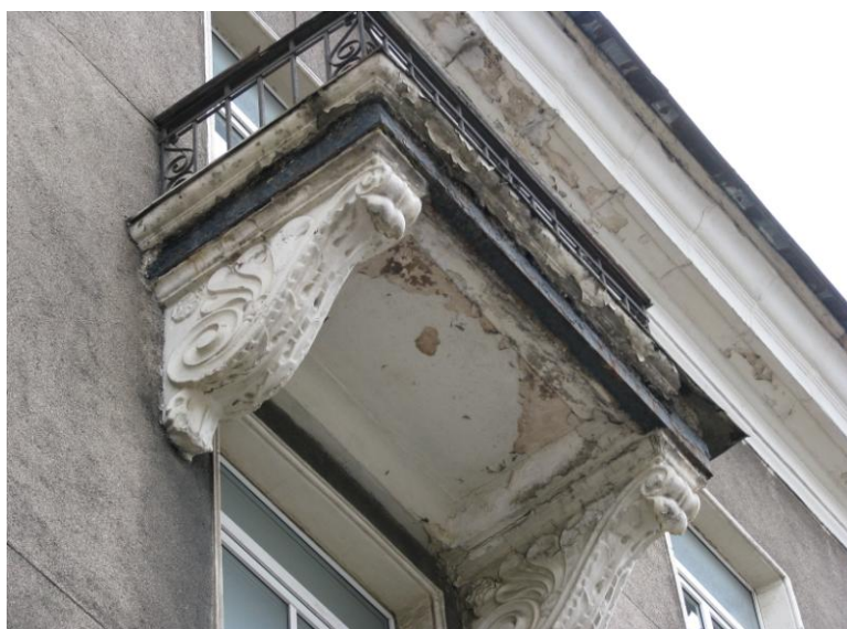
Foto 6. Rõdu terastalaid kattev karniis on suures osas hävinud, terastalad on servas paljandunud. Ebapiisava servapleki ja hüdroisolatsiooni tõttu esinevad plaadi alumises pinnas niiskuskahjustused. Remonttööde käigus tuleb taastada karniis. Eelnevalt kontrollida terastalade seisukorda. Terastalad ja korrodeerunud sarrus puhastada ja katta korrosioonikaitsevahendiga. Paigaldada servaplekid ja hüdroisolatsioon, piirded korrastada. Enne restaureerimistöid on vajalik teostada ehitustehniline ülevaatus ja koostada projekt, kus oleks näidatud muuhulgas ka puuduvate karniiside profiil ja nende kinnituslahendus.
