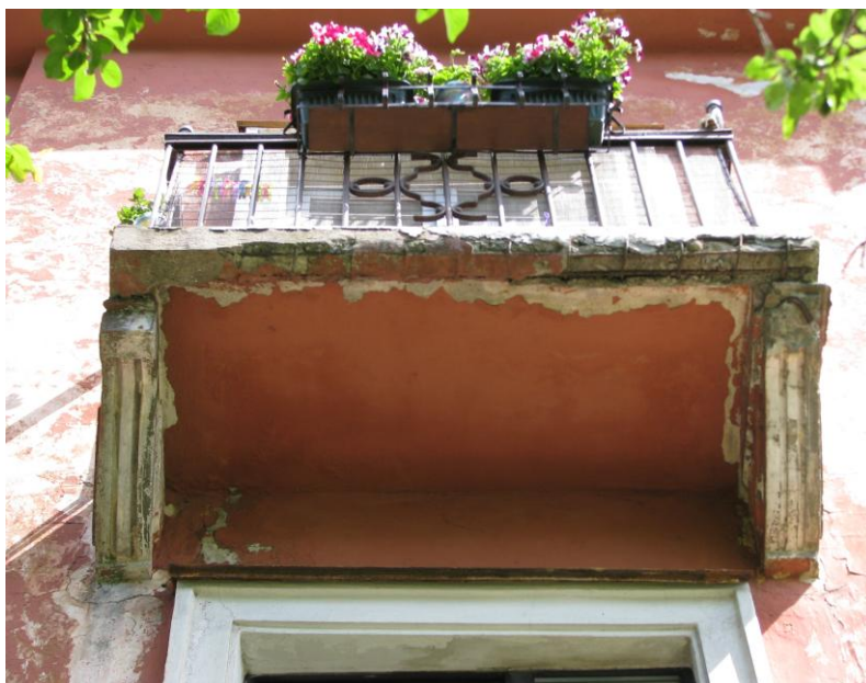
Foto 3. Piirde taha on paigaldatud liigsed katteplaadid. Puuduva servapleki tõttu on rõduplaadi äär oluliselt lagunenu. Värvkate ja lahtine betoon eemaldada. Sarrusvardad puhastada, vajadusel lisada täiendav terasarmatuur. Teostada kohtparandused. Tagada rõduplaadi kalded, paigaldada hüdroisolatsioon koos ülespöörete ja servaplekiga.
