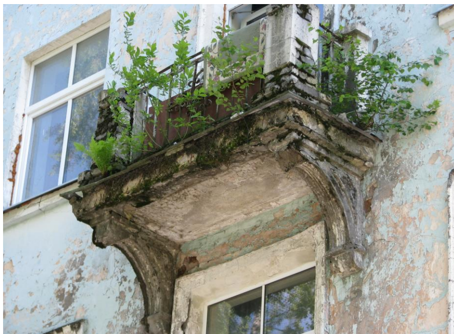
Foto 8. Rõdu on hooldamata, sadevee äravool on takistatud. Esmalt eemaldada taimestik ja puhastada rõdu pinnad vanadest viimistluskihtidest. Liigniiskuse tõttu on tõenäoliselt rõdu plaadi sarrus hakanud korrodeeruma. Enne remonttöid hinnata puhastatud rõdu seisukorda ja näha ette sobivad lahendused.
